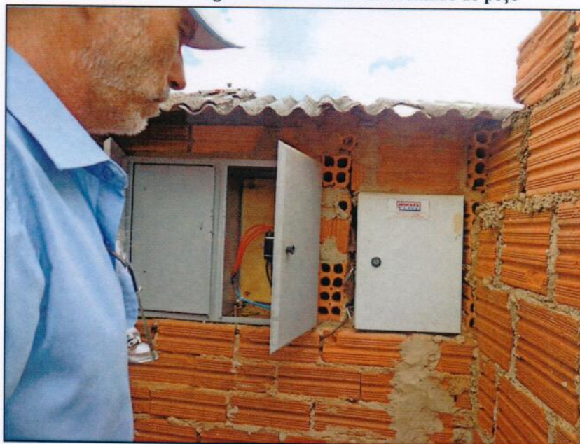
Foto 14 - Bairro Águas Claras - Painel de comando do poço
