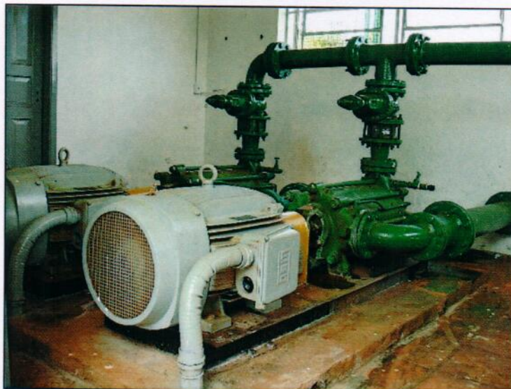
Foto 4 - Vista interna - equipamentos da EEAT 01
