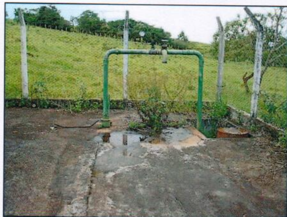
Foto 2 - Poço PPS03 (fora de operação)
