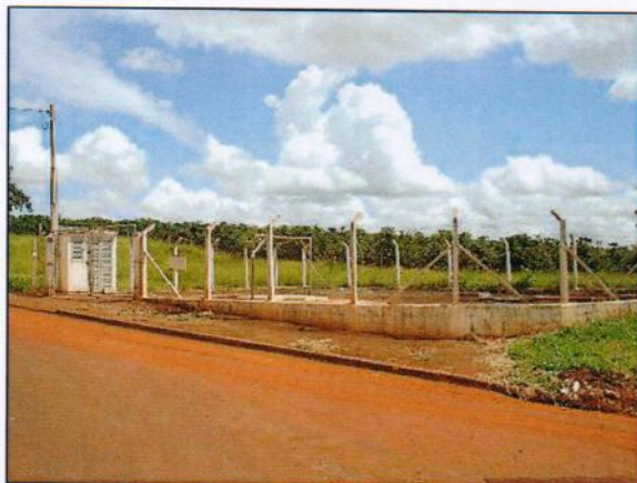
Foto 7 - Estação Elevatória 01 (EEE01)
